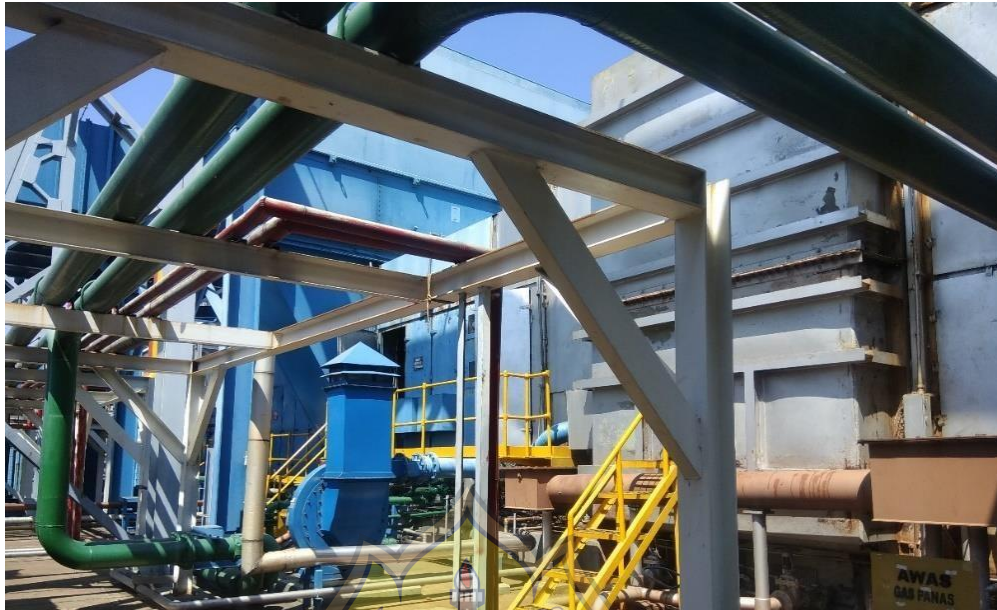
Gambar 2.10 Turbin Gas Tampak Luar Unit GTG 2.3
